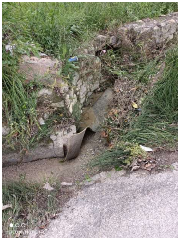
Figura 22. Tramo de acequia anegado en el cruce de la antigua carretera de Pliego, con el nuevo vial que da continuidad a la Avenida de La Paz hasta la Carretera de Caravaca. Los restos de malezas y otros objetos hacen desbordar el canal, en cuanto se producen leves precipitaciones
