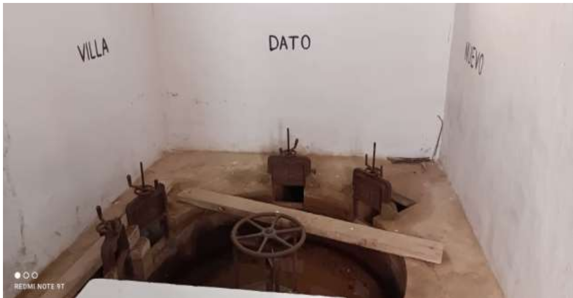
Figura 5. Interior del partidor de Villa-Dato y Nuevo, lugar de llegada de las aguas del embalse, a través del Canal Bajo. Obsérvese la manivela de accionamiento para la entrada del agua, y las tres salidas, hacia sendos parajes, donde algunos agricultores todavía conservan el regadío a manta
