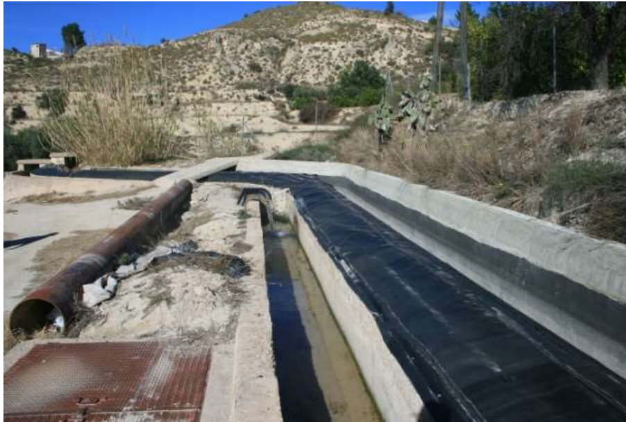
Figura 4. Conexión del final del tramo alto de la Acequia Mayor, con el embalse de Trasto, correspondiente a las infraestructuras del plan de modernización de regadíos (Ribera de Los Molinos)
