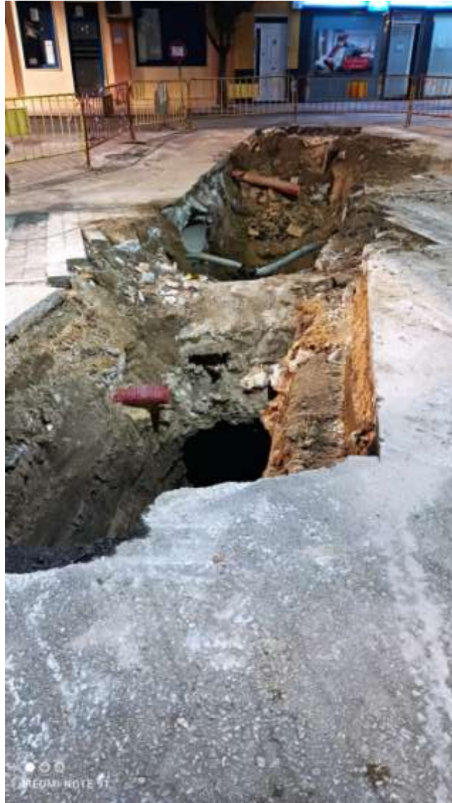
Imagen 8. Ramal de riego, descubierto en las obras de remodelación de la Gran Vía, durante el año 2022, en la unión de esta calle con Avenida Explanada.
