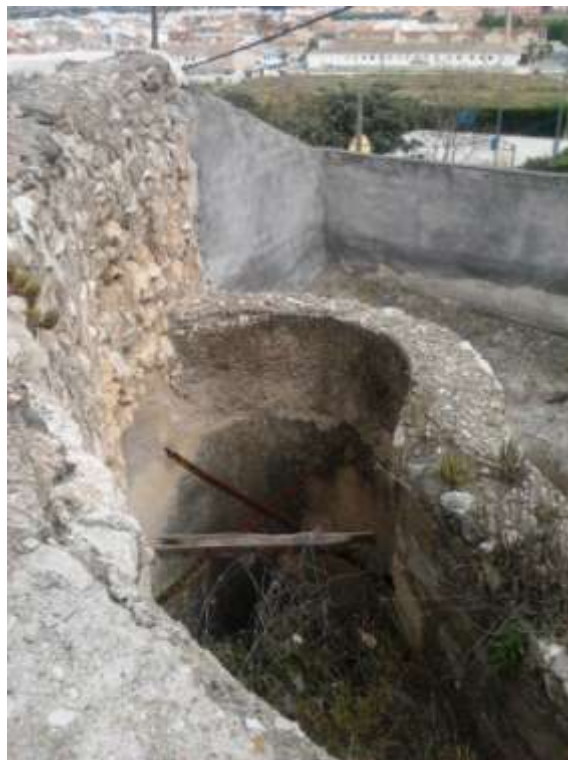
Imagen 5. Estado actual del cubo de entrada al molino Pintado, anegado de maleza y en mal estado.
