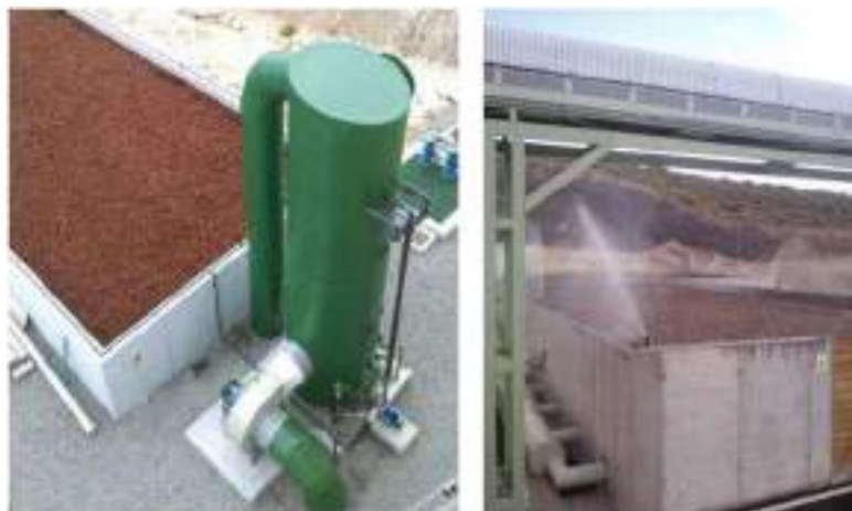
Ilustración 10 Ejemplo de sistema de desodorización (izq.) y sistema de riego del lecho (dcha.)
