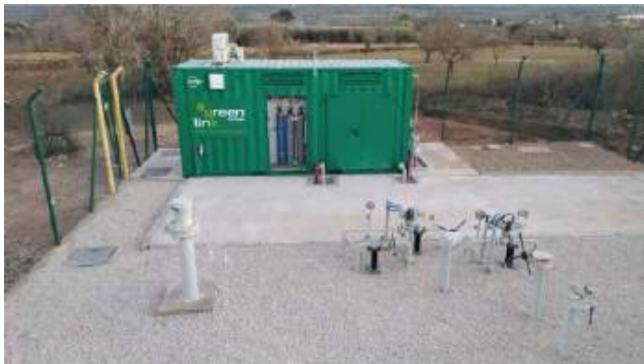
Ilustración 8. Imagen de módulo de inyección del biogás para su posterior transporte
