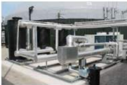
Sistema de enfriamiento de biogás
