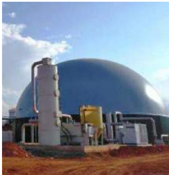
Ilustración 6. Equipo de sistemas de desulfuración química
