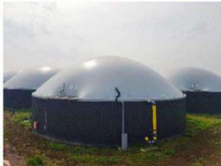
Ilustración 2. Digestor de mezcla con gasómetro de doble membrana y agitación mecánica
