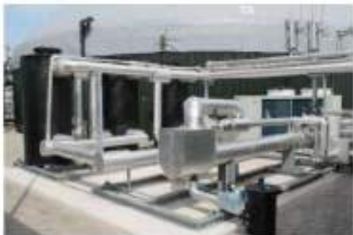
Sistema de enfriamiento de biogás
