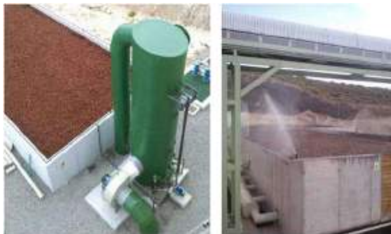
Ilustración 10 Ejemplo de sistema de desodorización (izq.) y sistema de riego del lecho (dcha.)
