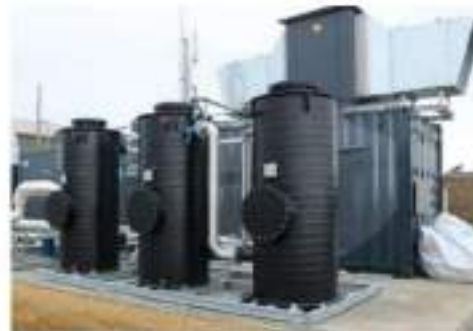
Sistema de filtración de biogás
