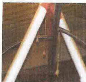
Canalizaciones de agua
